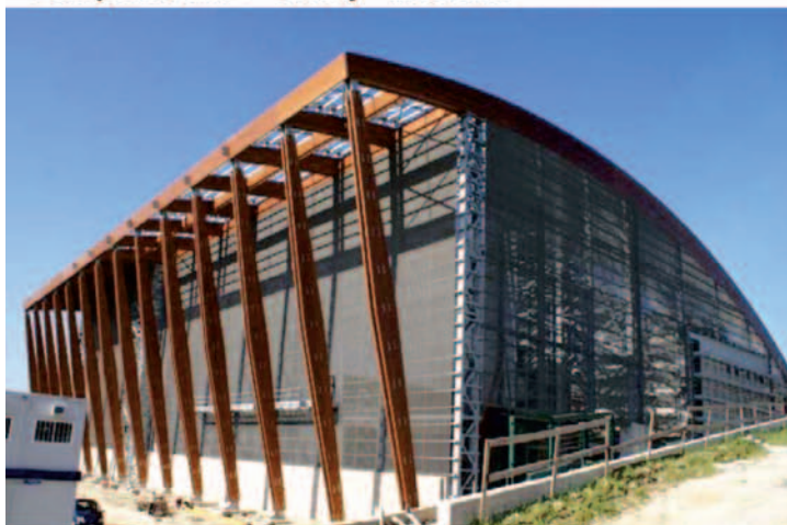
▲ Centrale di Gassificazione CDR - Roma - Italia
